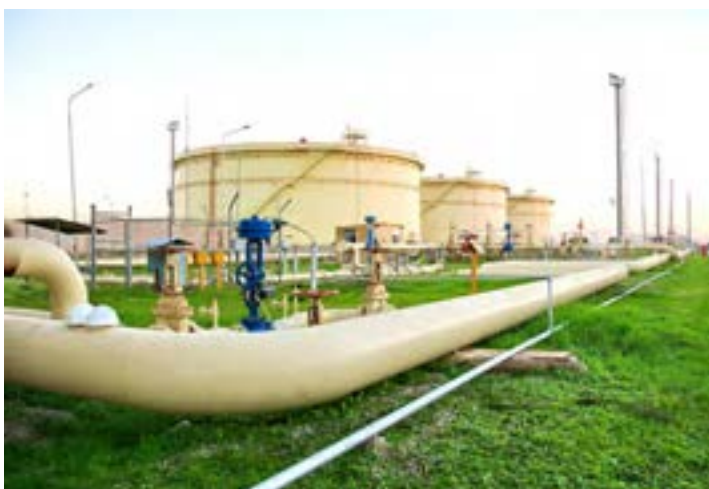
شکل ۲۰- نمایی از خطوط انتقال سوخت
