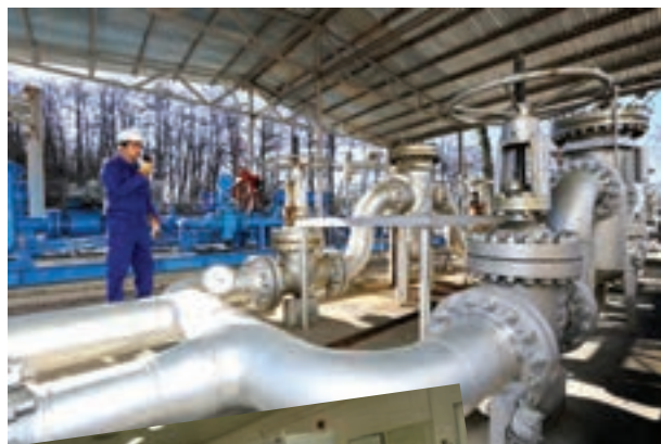
منطقه شمال، ایستگاه فشار شکن لاجیم
