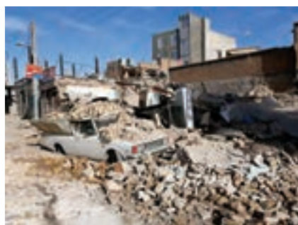
کیفیت ساخت و ساز با میزان آسیب پذیری ساختمان در برابر زلزله ارتباط دارد.
