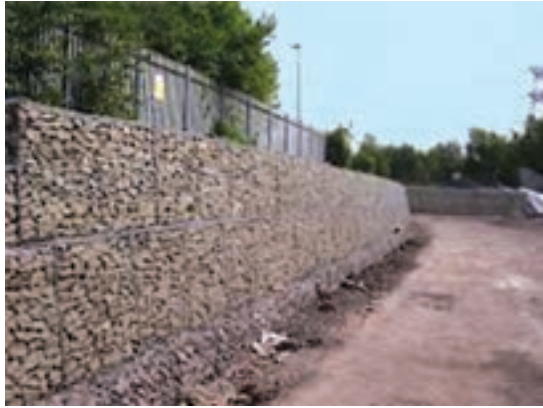
دیواره حائل برای حفاظت از سکونتگاه‌های حاشیة رودخانه گرمابدره سرشاخه جاجرود در استان تهران
