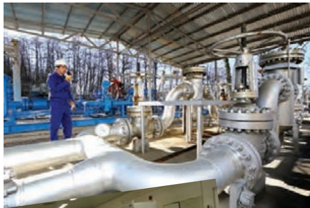
منطقه شمال - ایستگاه فشارشکن لاجیم
