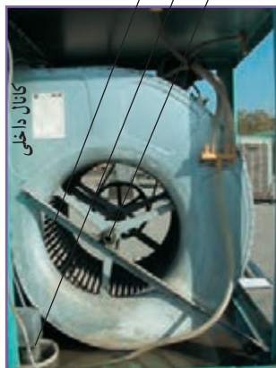
الف- نمای سمت پمپ کولر آبی
